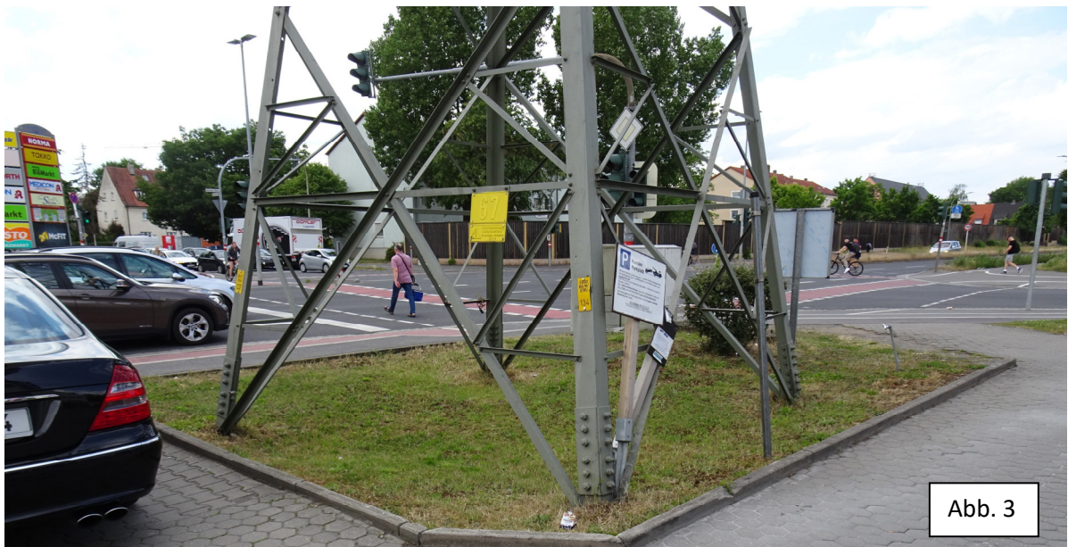
Abb. 1: Mast 67, in Leitungsrichtung
